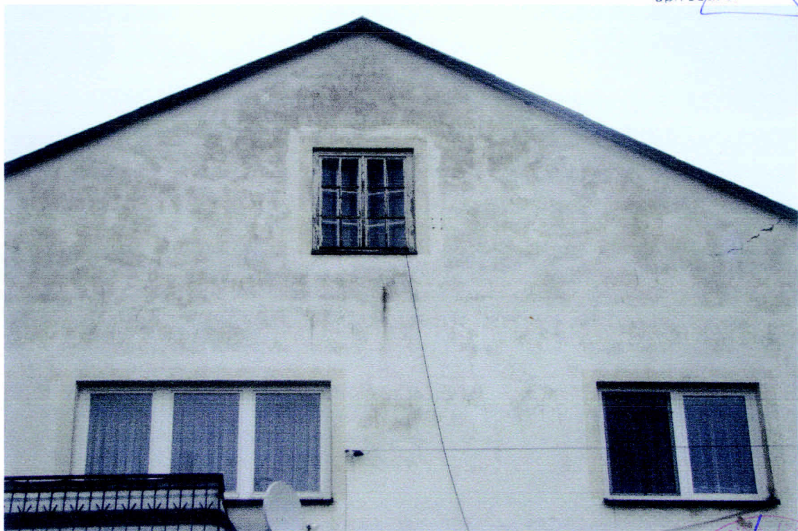
Fot. 6. Elewacja szczytowa zachodnia – widoczne zarysowanie w rogu budynku.
