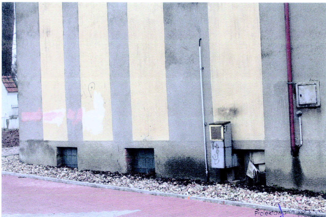
Fot. 6. Widok stanu zachowania dolnych partii murów
